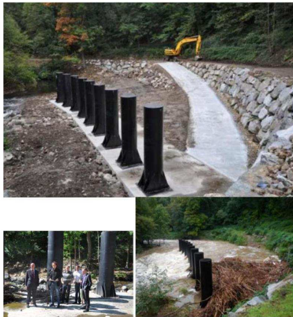
Figure 44 : Illustrations du piège à embâcles sur la Déôme en amont d'Annonay
