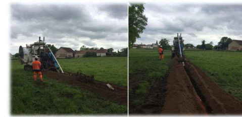
Figure 144 : Exemple de chantier d'enfouissement d'un réseau électrique en terres agricoles (Source : Cegelec infra)
